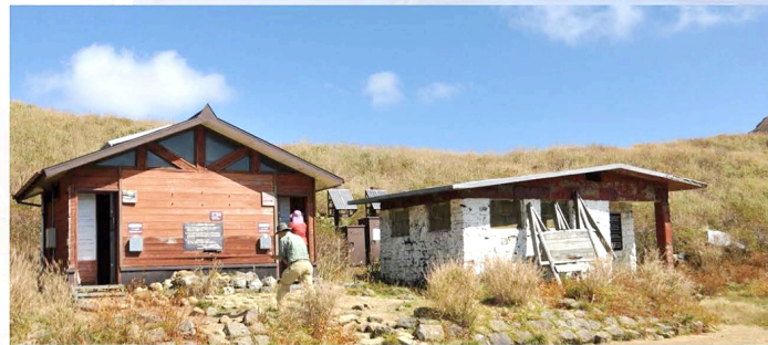
▲建替前の避難小屋。すでに雨漏りが酷く使用不能となっていた
